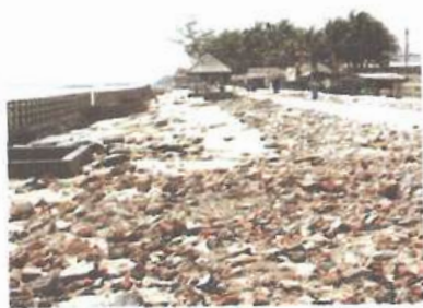
ปี 2550 พื้นดินเมื่อดึงกำแพงแตกเสียหายและ ต้องซ่อมแซมทุกปี
